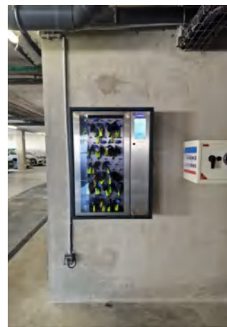
ecos 80 dans un parking souterrain en France
